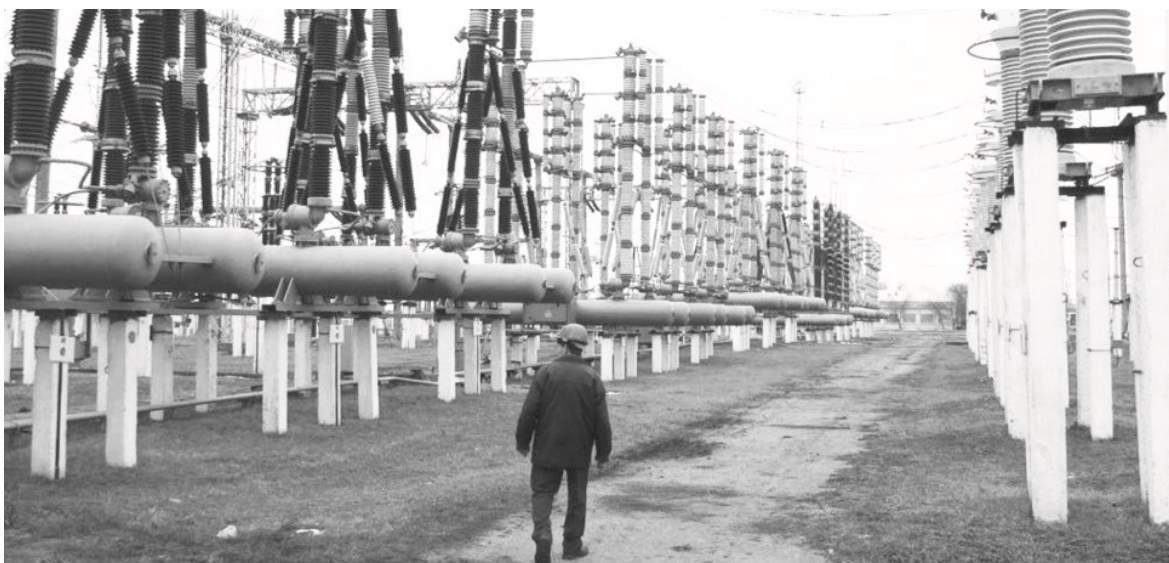
Будні на підстанції
